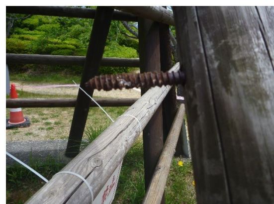
脱落したボルト
