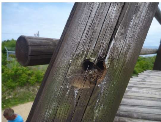
ボルトが脱落した支柱
