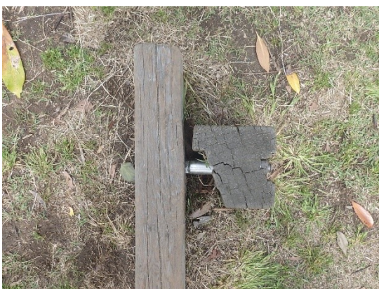
事故発生状況
