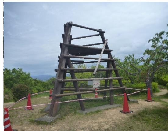
事故発生状況
