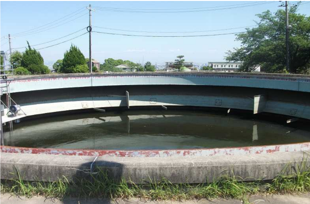
② 工水沈殿池1号
