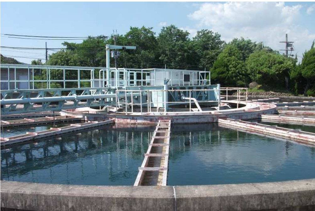
③ 工水沈殿池2号
