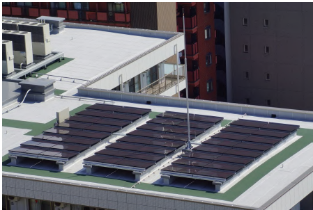
屋上に配置された太陽光発電設備事例
