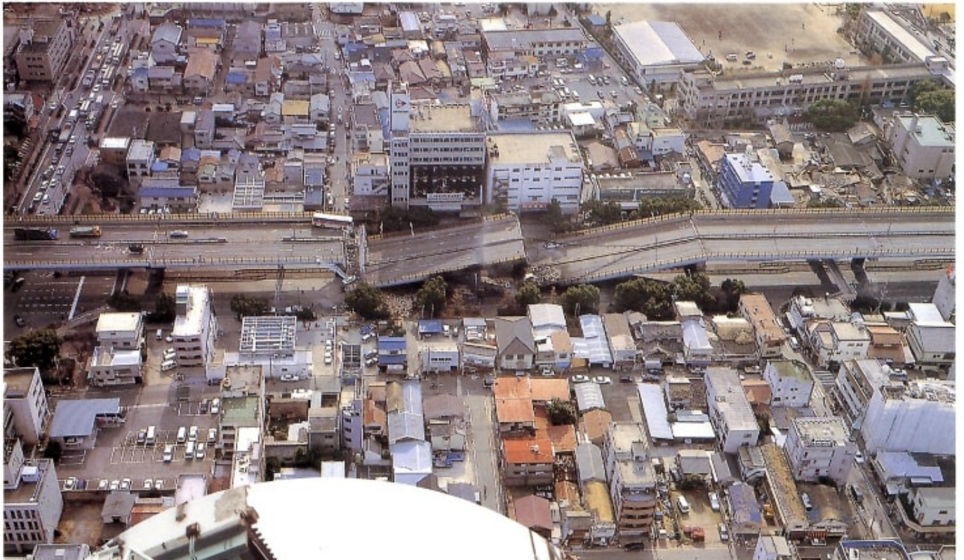
▲ 高架部分が崩れ落ちた阪神高速道路：神戸線
