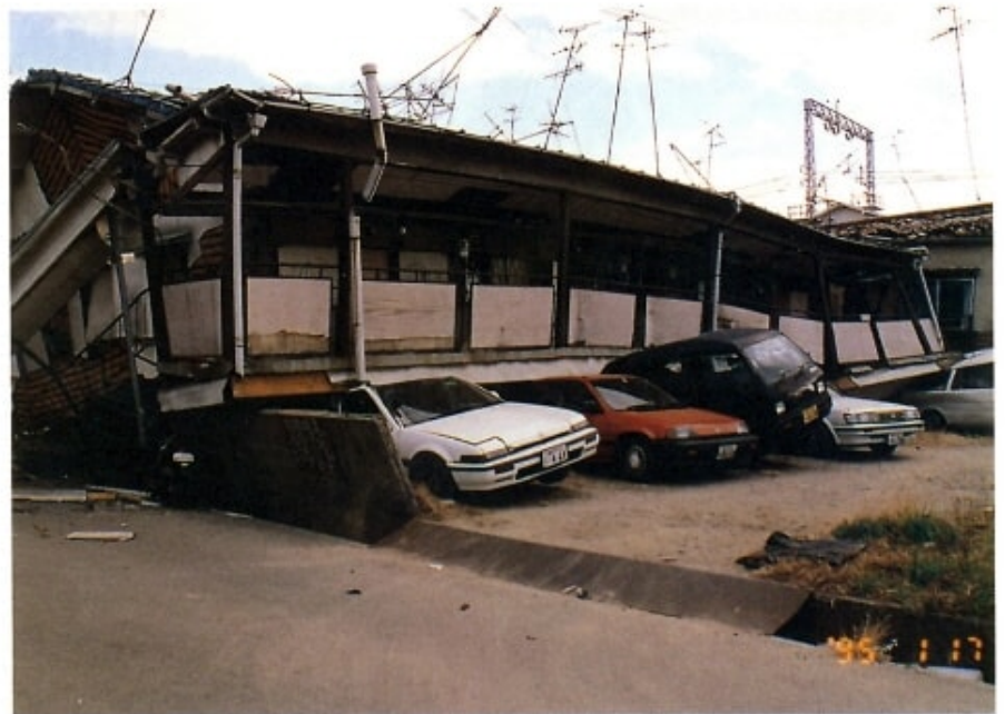
共同住宅の1階部分が壊れ ▶ 駐車場の車両も破損 (青木町)
