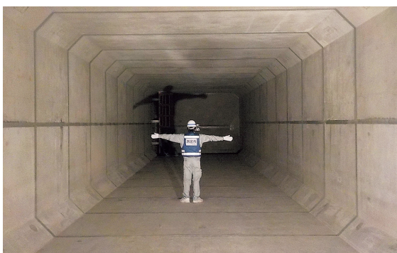
鳴尾駅前雨水調整池(内部)
