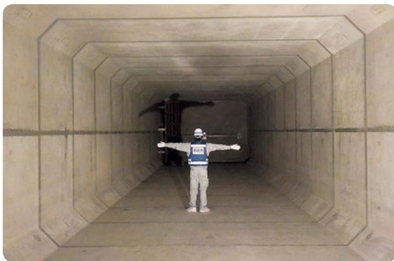
鳴尾駅前雨水調整池（内部）
