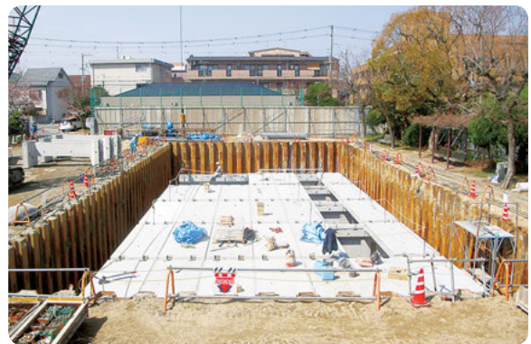
二見公園雨水調整池（地上）
